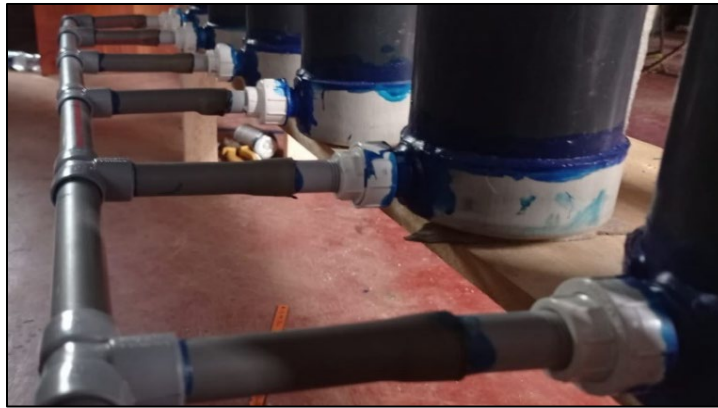
Figura 7. Sistema de salida de biol del biorreactor NBS Gas Home Organic Reactor
