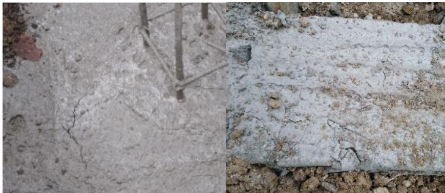
Figura 2. Fisuras producidas en zapata y viga de cimentación como consecuencia de no haber sido curadas.
